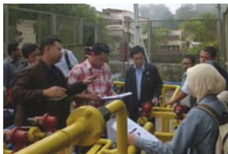
Audit keselamatan gas sedang dijalankan oleh pegawai-pegawai ST.
