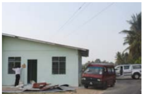
Penguatkuasaan aktiviti pembinaan rumah di bawah talian di talian voltan tinggi 33 kV Kubang Rawa, Sator, Kelantan.
