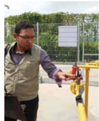
Pegawai penguatkuasa ST sedang memeriksa bacaan pada meter gas bagi memeriksa tekanan gas.
