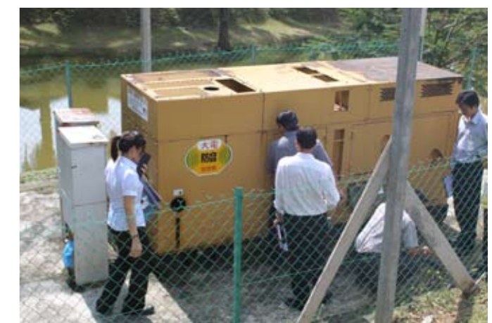
Pemantauan pemasangan yang tidak berdaftar di Kuala Kubu Bharu, Selangor.
