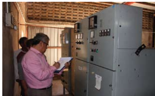
Pemeriksaan ST ke atas pemasangan jana kuasa yang tidak berlesen dan tidak berdaftar
