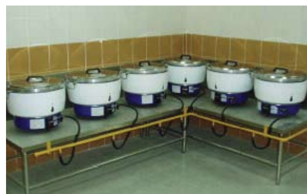
Antara Perkakas Dan Kelengkapan Gas Yang Dikawal
