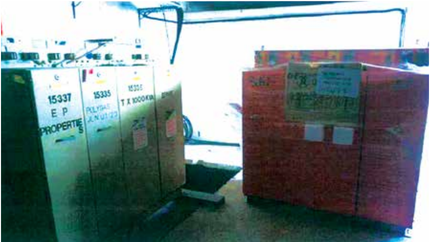
Alat Suis RMU 11kV Yang Lama (Kelabu) Akan Digantikan Dengan Alat Suis Yang Baharu (Oren)
