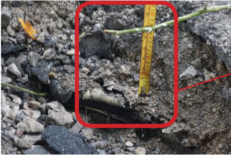
Gambar 13: Kedalaman Kabel Hidup yang Rosak Akibat Terkena Jentera Korekan
