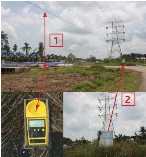
Gambar 5: Ketinggian Talian dan Tanda Amaran 1. Ukuran Ketinggian Antara Talian Paling Bawah dengan Tanah (12.41meter) 2. Tanda Amaran Bahaya Talian Penghantaran Dalam Keadaan Tidak Memuaskan Seperti Tersorok dan Usang
